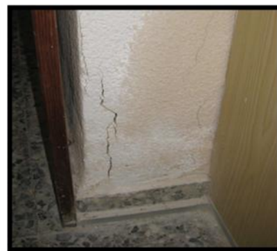
Fisuras en el revestimiento del pilar, coincidentes con las esquinas del mismo, hasta una altura aprox. 60cm.
