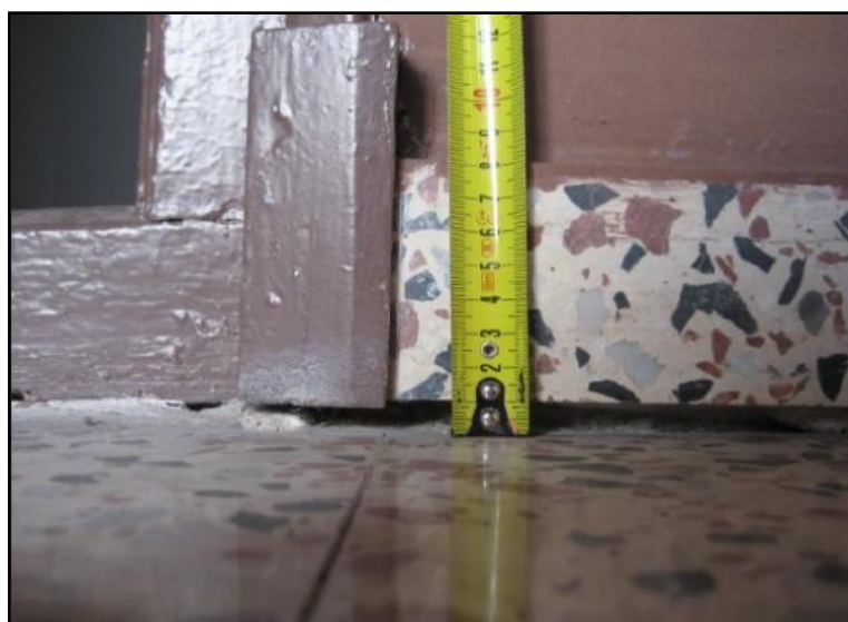
Ilustración 22. Utilización de un metro para demostrar la deformación del pavimento de un forjado que ha flectado.
