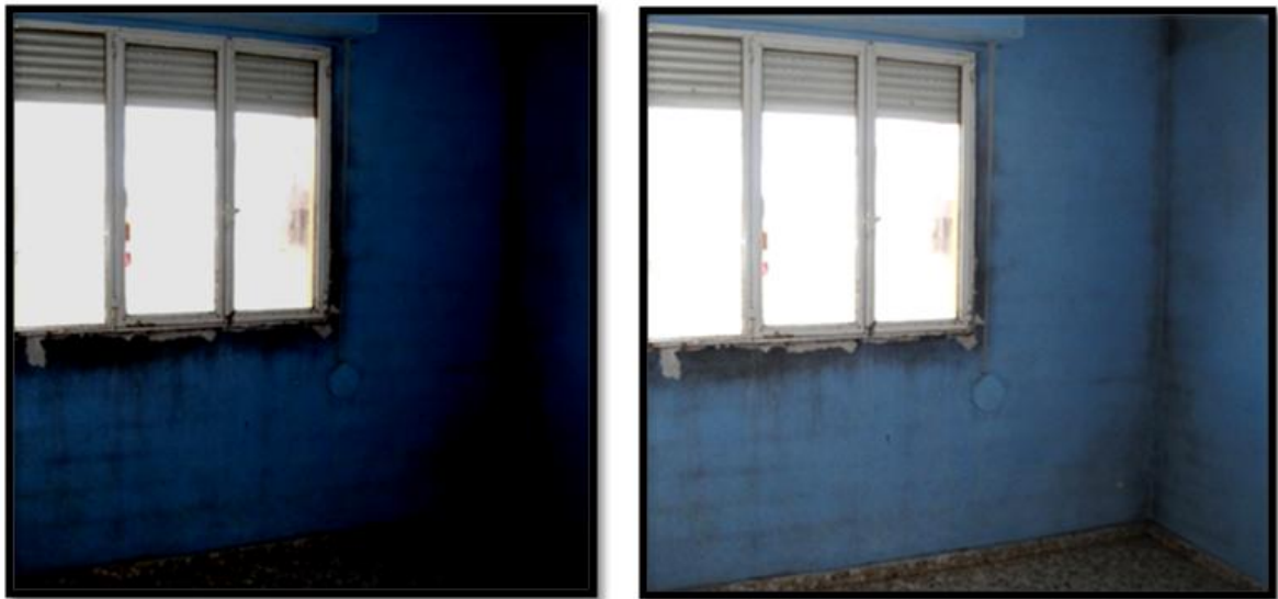
Ilustración 18. Toma original y toma optimizada para una correcta exposición. Fuente: Curso de Especialización en Inspecciones Técnicas de Edificios impartido por la Universidad de Alicante en el curso académico 2012-2013.
